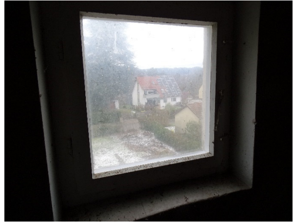
Abb. 5: Verschlossene Fenster im Dachstuhl
