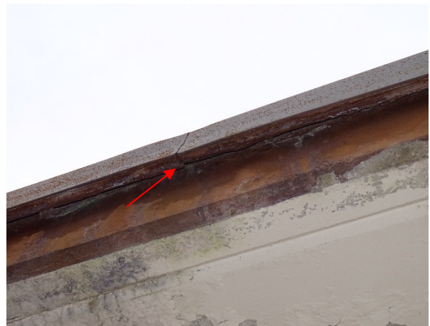
Abb. 12: Verschlossene Attikaspalte an Garage (roter Pfeil)
