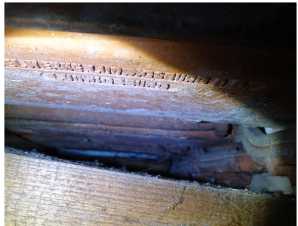
Abb. 7: Schmalere Hohlraum in Dachvorsprung
