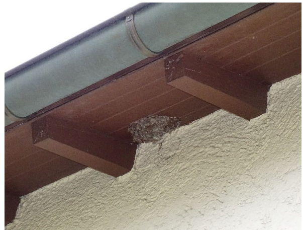
Abb. 9: Wespenestrest an östlichem Dachvorsprung
